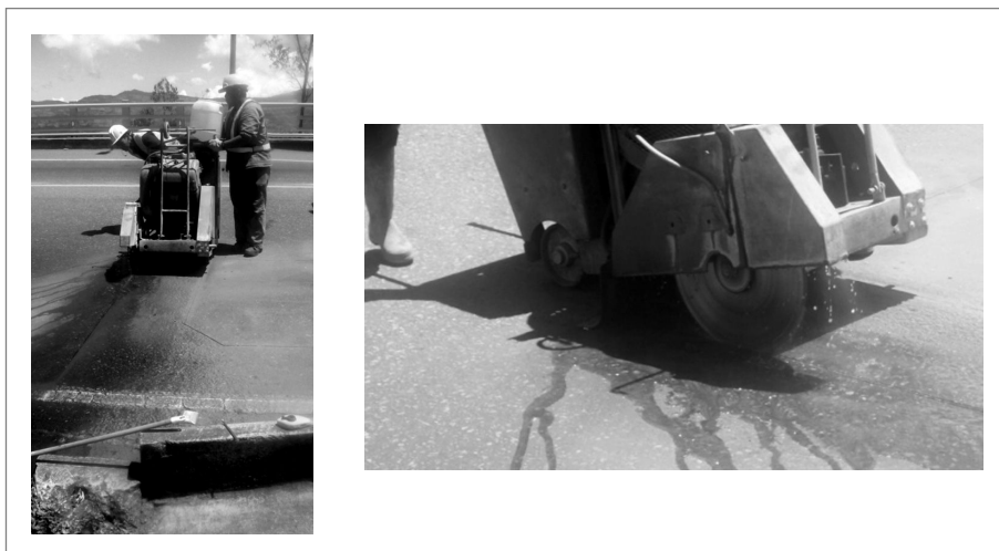
Figura 5. Cortes en el pavimento para la instalación de los Loop inductivos y cables piezoeléctricos Figure 5. Pavement cutting for the installation of inductive loop and piezoelectric wires
