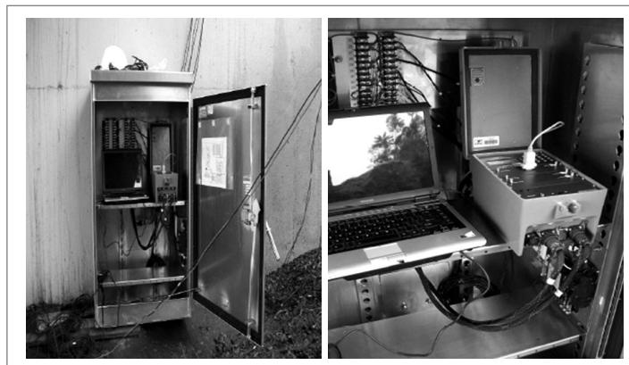
Figura 6. Gabinete con las conexiones electrónicas, el sistema suministrado por la empresa Canadiense IRD - International Road Dynamics Inc. y un computador para la adquisición de los datos de conteos y medición de los vehículos que circulan por el puente. Figure 6. Electric connection cabinet of the system supplied by Canadian IRD – International Roads Dynamics Inc; computer for data collection of counting and measurements on vehicles travelling on the bridge
